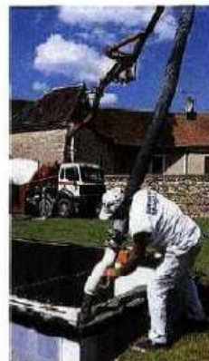
Le coulage du béton se fait en effectuant 2 ou 3 passages pour équilibrer les pressions dans les panneaux.
