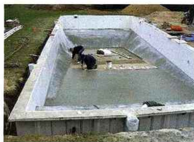
Une fois la mise en place du béton effectuée dans la structure, on procède à la réalisation de la chape ciment du radier de fond.
